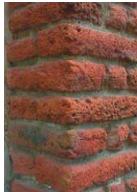
Sablage abusif de la brique
