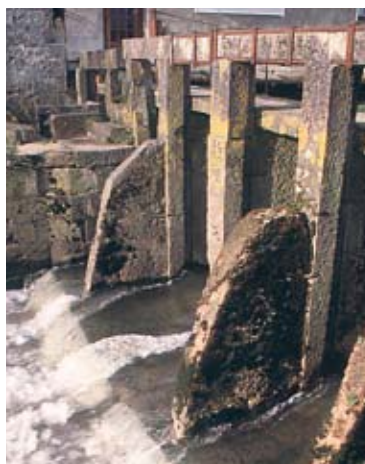
État sanitaire des arches en pierre des ventelles - Boulogne sur Helpe
