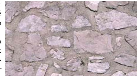
Le cimentage outrancié des joints gomme l'irrégularité de ce mur de moellons
